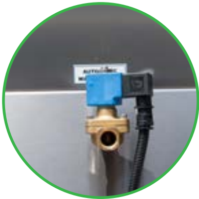
ELETROVÁLVULA DE ENCHIMENTO
